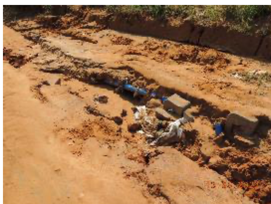
Figura 3-7. Presença da adutora do FIPAG
