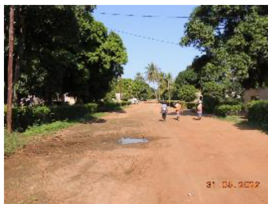
Figura 3-4. Surgimento de poças de agua na zona baixa cerca do km 0+140
