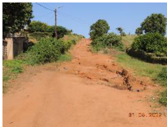
Figura 3-2. Condição do pavimento na subida íngreme
