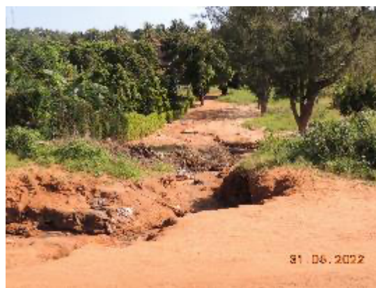
Figura 3-6. Erosão na berma esquerda da estrada
