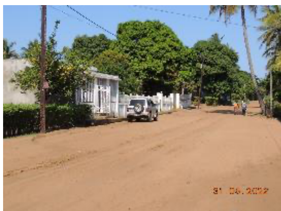
Figura 3-3. Surgimento de rodeiras devido a fraca capacidade do pavimento
