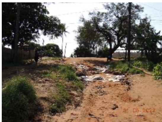
Figura 3-1. Condição do pavimento junto ao cruzamento com a EN1
