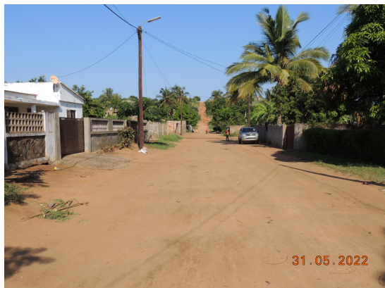
Figura 3-9. Pormenor de candeeiro instalado no poste da linha de baixa tensão, lado esquerdo
