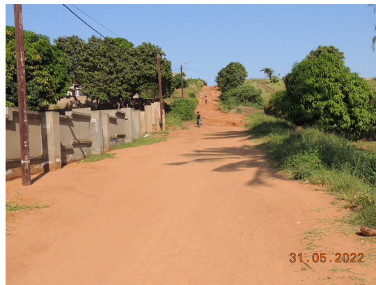
Figura 3-10. Os últimos vãos da linha de baixa tensão no lado esquerdo
